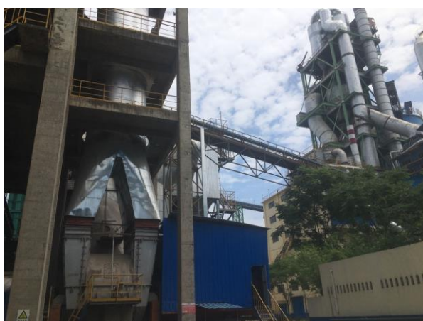
两条窑线连接管道
