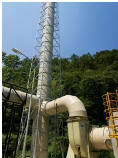
废气处理排气筒
