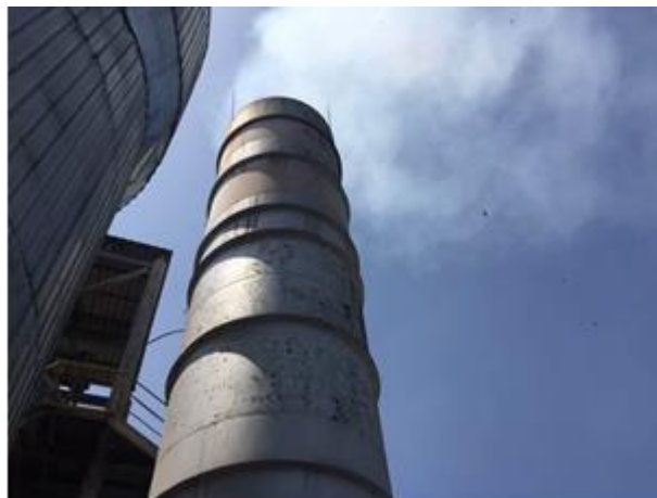
水泥窑窑尾排气筒
