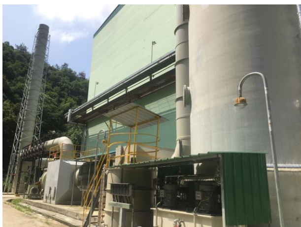
预处理车间废气处理
