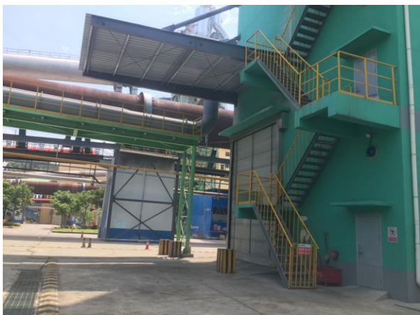
投喂系统抽风管道
